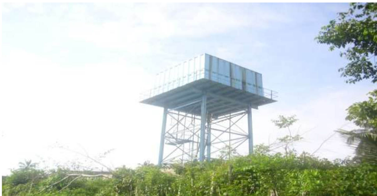
Photo 3 : Un château d'eau abandonné et entouré d'herbes à Akwa (Bakassi)
