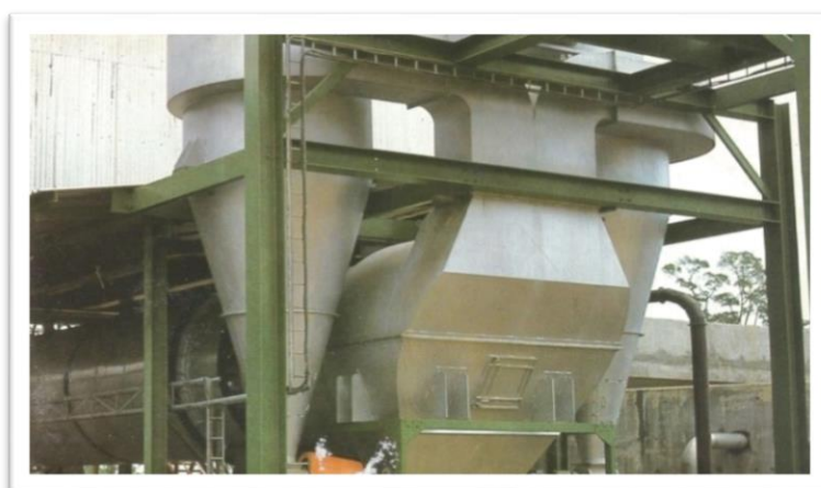
Photo 11 : Sécheur rotatif à boue des eaux usées de l'usine CELLUCAM (Edéa)
