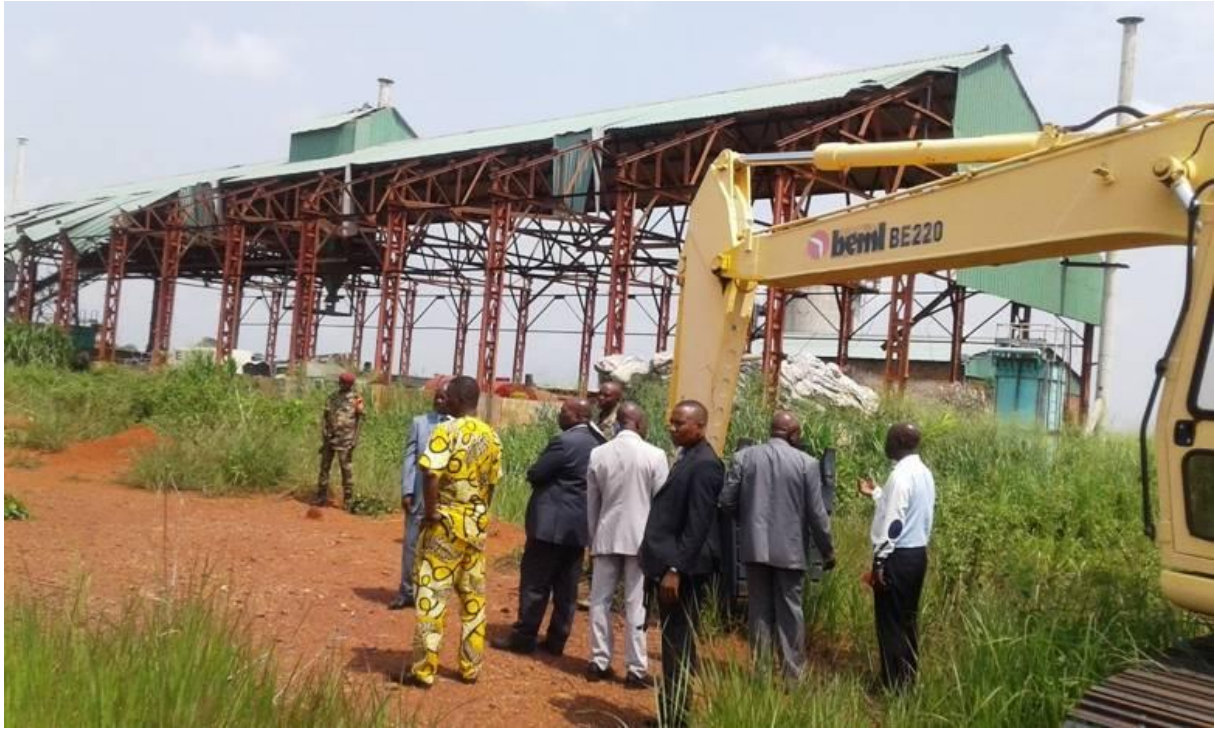
Figure 40 : Site de la cimenterie de Nzila vandalisé
