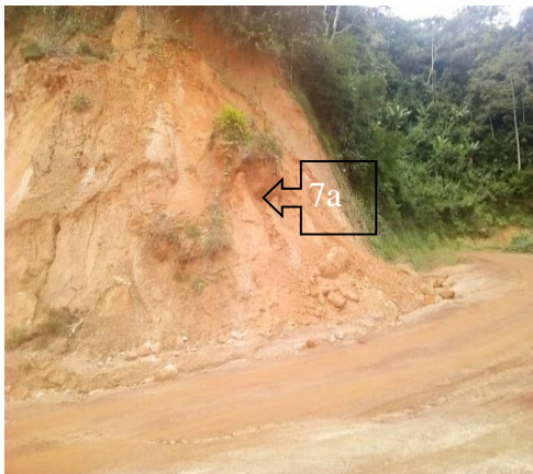
Risque d'éboulement sur la route de Bagnoun Ngassam, juillet 2020
