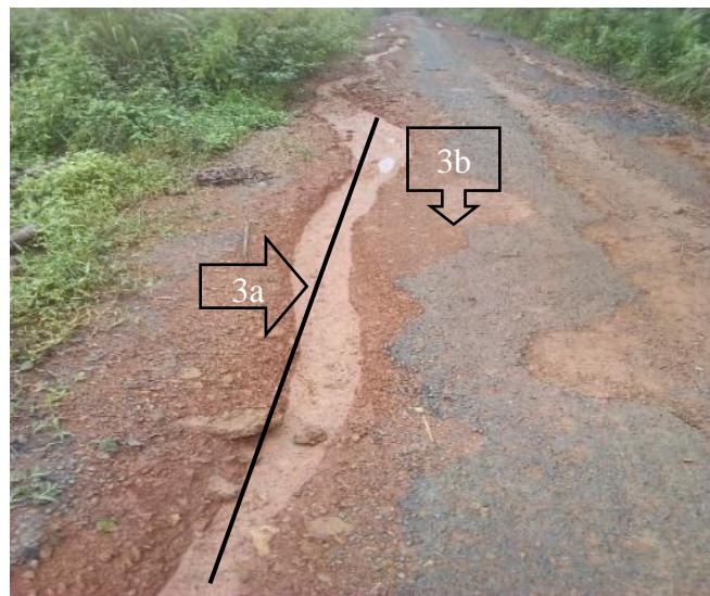
Erosion sur la route de Mangou-Kouba Ngassam, juillet 2021
