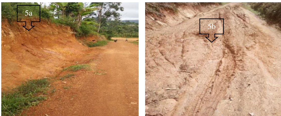
Dégradation routière à NDJEUMACK
