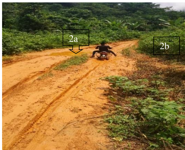
Coulée de boue, route Bassoumdjang-Moya Ngassam, juillet 2021
