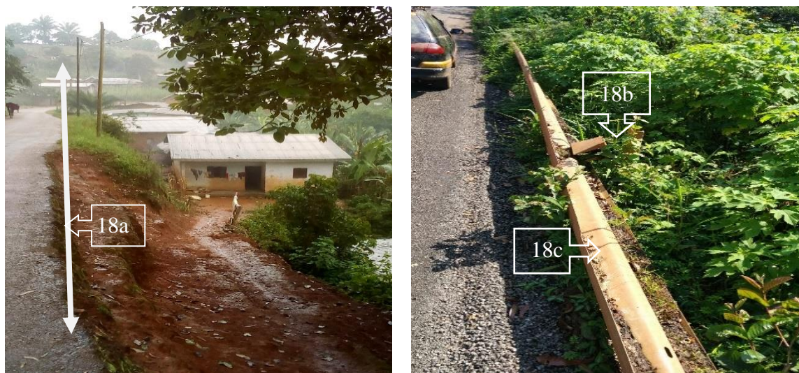
Garde-fou inexistant au quartier Nylon, et désuet à Katio, sur l'axe Bamena-Bazou Ngassam, juillet 2021
