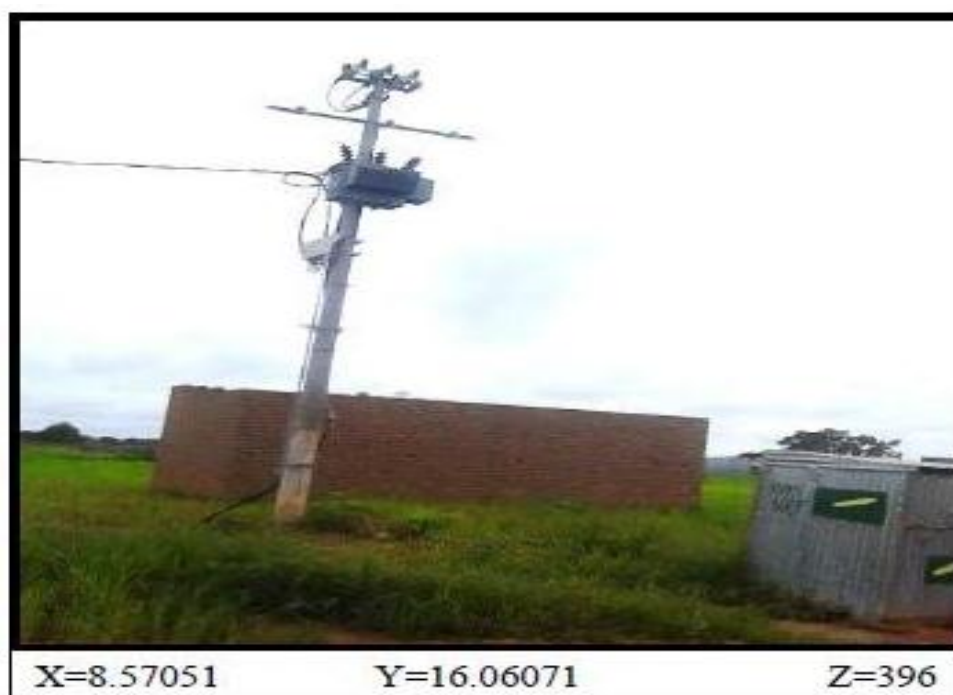
Photo 4: Poste de transformation
