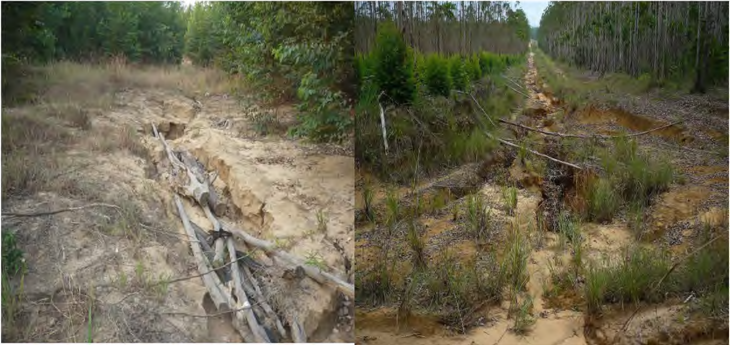
Photos (25 et 26) : Dégradation respective d'une piste et d'un coupe-feu par des ravines à l'intérieur des champs d'eucalyptus et rendant l'accès difficile à Kondi (Cliché Mayima, 2012)
