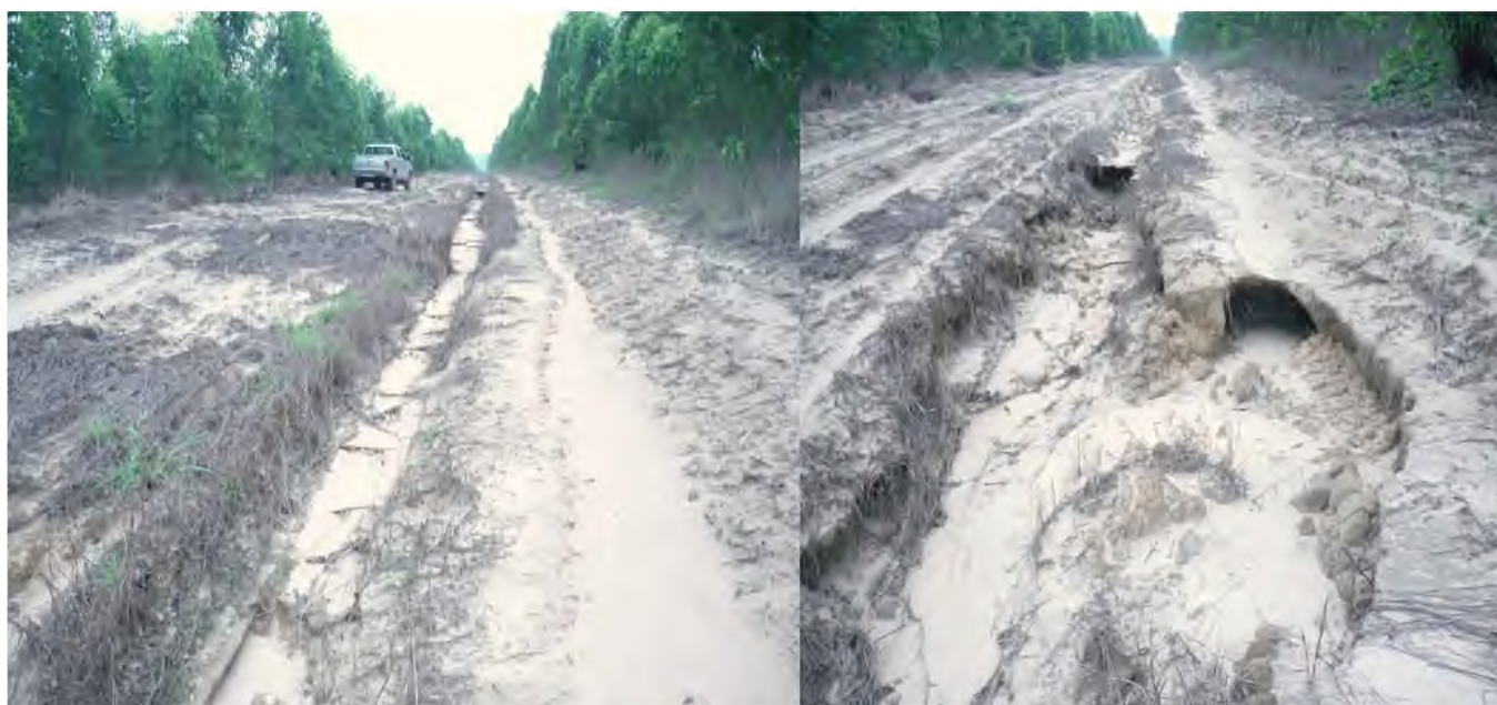
Photos (23 et 24) : Dégradation d’un coupe-feu à Kissoko le 22 mars 2012, après la pluie du 21 au 22 mars 2012 (Cliché Mayima, 2012)
