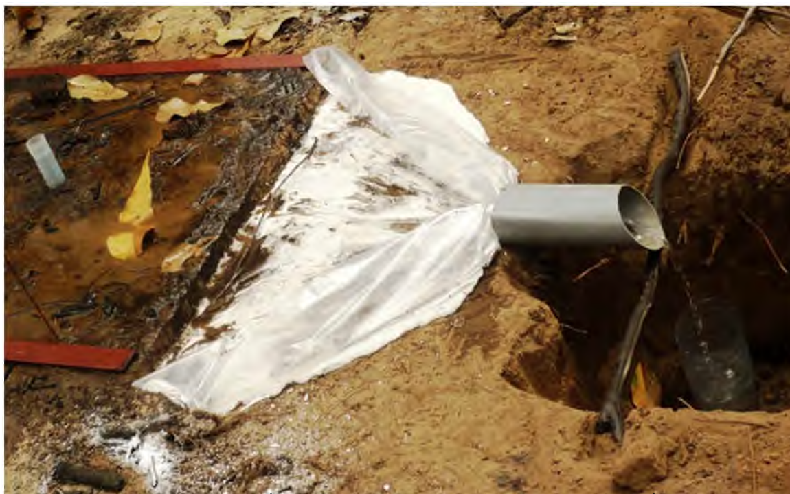
Photo 16 : Dispositif de réception des eaux du ruissellement (Cliché Mayima, 2012)
