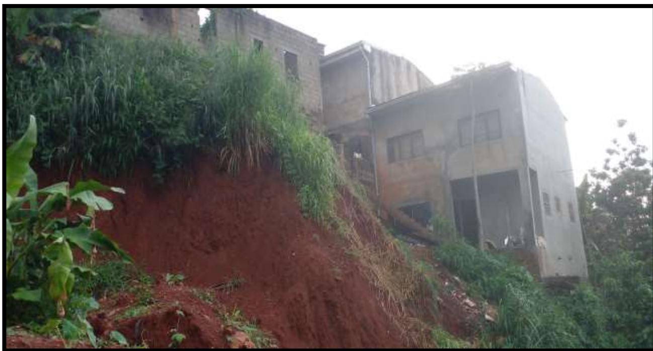
Photo 1 : Effondrement de terrain
