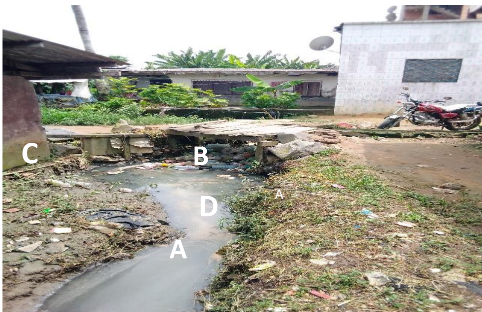
Photo 3 : Obstruction d'un canal d'évacuation par les ordures à site SIC.
