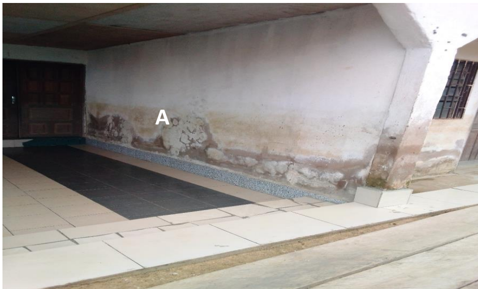
Photo 10 : La hauteur des inondations affectant une maison à Bonamoussadi.
