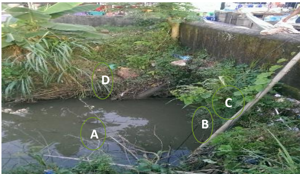
Photo 12 : Drain obstrué au Parcours VITA.
