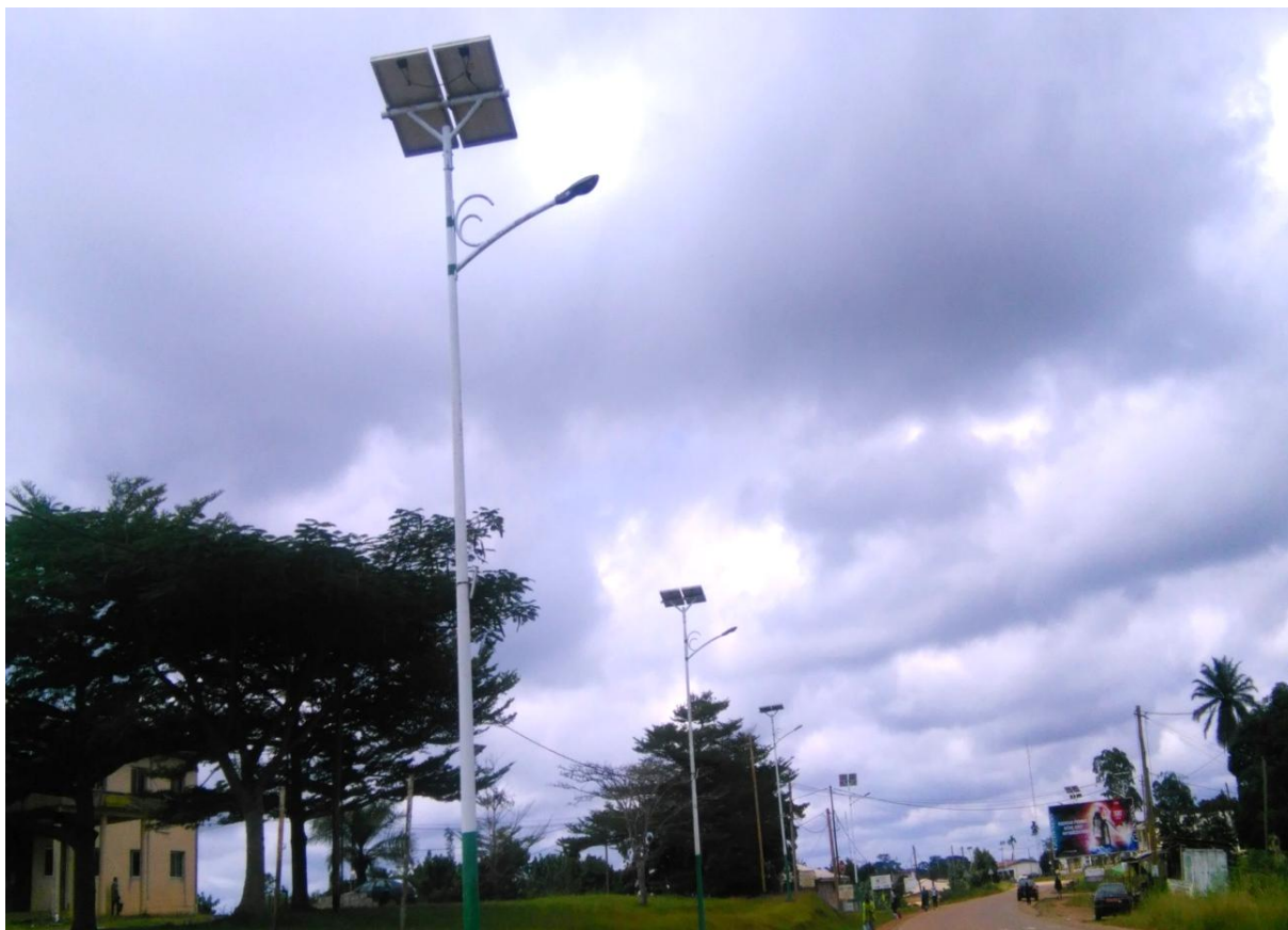
Photo N°28: Plaques solaires dans le centre-ville de Ngoumou.
