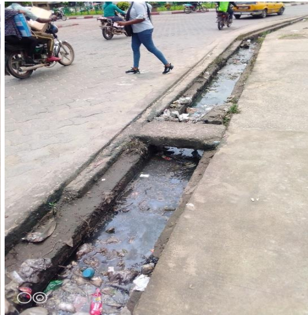
Image 13 : Obstruction des canalisations à la suite d'un dépôt sauvage d'ordures à Beedi
