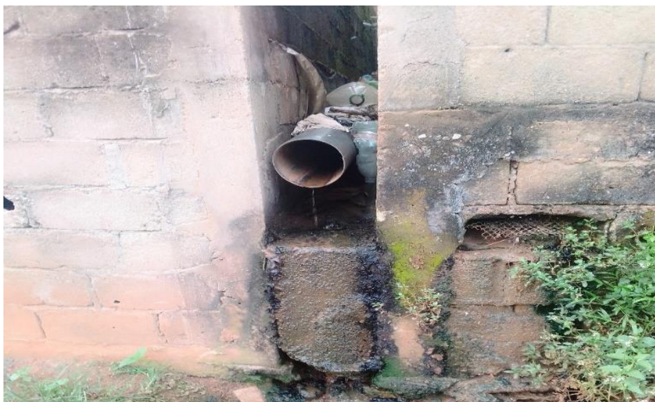
Image 9 : Vanne d'évacuation des déchets humains ouverte en plein air
