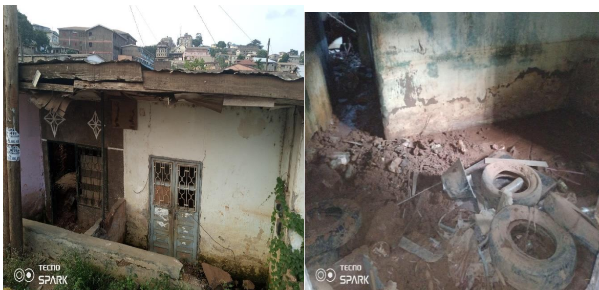
Photo 14a maison abandonnée suite à la dégradation du bâti
