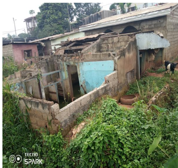
Photo12b. mur et charpente d'une Maison entièrement effondrés au quartier Etoug-ebe
