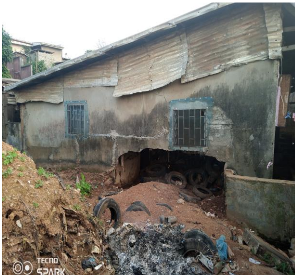
Photo 12a mur d'une maison partiellement perforée par les eaux
