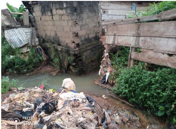
8a : maisons construites sur le nid d'un cours d'eau au quartier Biyem Assi
