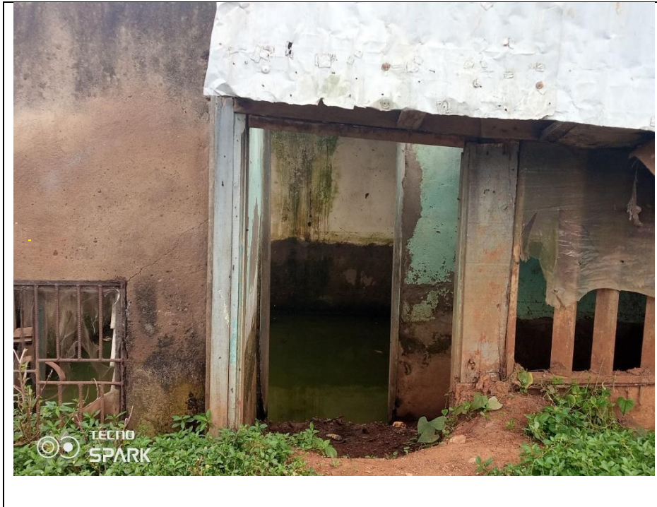
Photo 13: Situation d'une maison affaissée en zone inondable (Source, KWATCHO Etoug-ebe 2, Juillet 2022)
