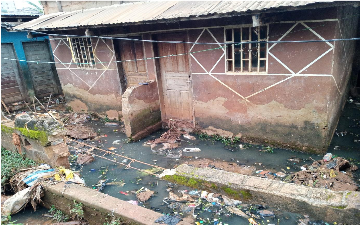
Photo 7: Situation d'un habitat spontané en zone inondable
