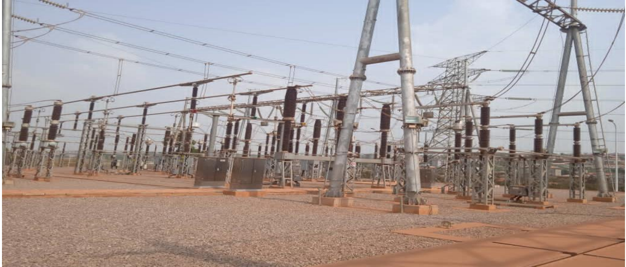
Photographie 6 : Equipements de la ligne 225KV Ahala-Abong-Mbang.
