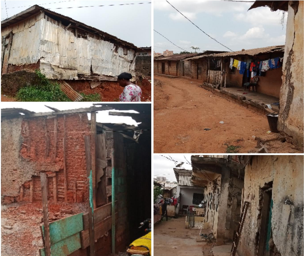
Figure 3 : Maisons construites en matériaux précaires et en état de délabrement à Bata-Nlongkak
