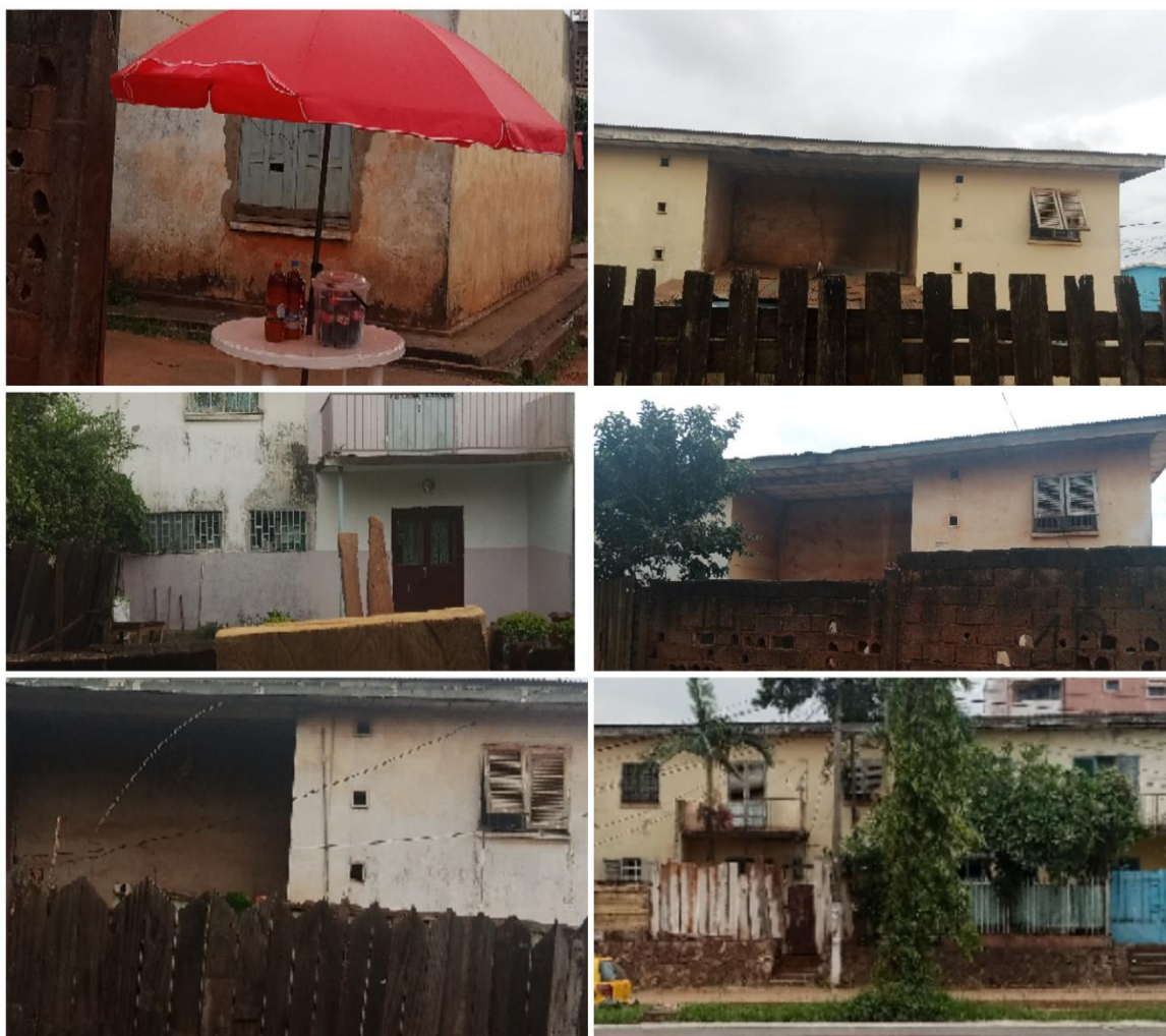
Figure 4 : Aperçu de l'état précaire des cités SIC de Nlongkak
