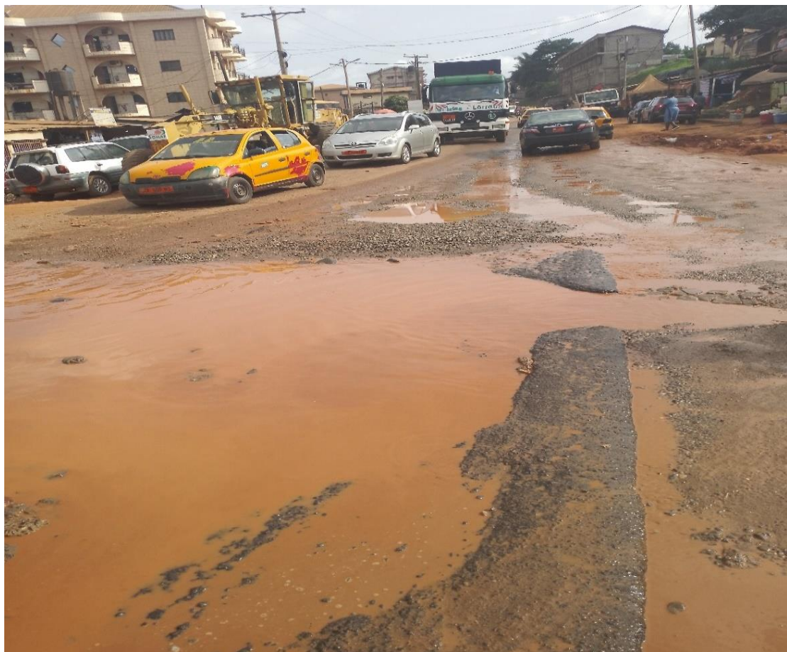
Image 2 : Route dégradée entre le carrefour Tropicana et ENEO Tropicana
