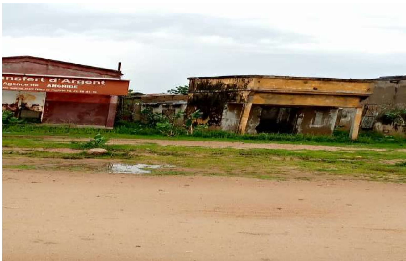
Photo 5: Edifices détruits par Boko Haram
