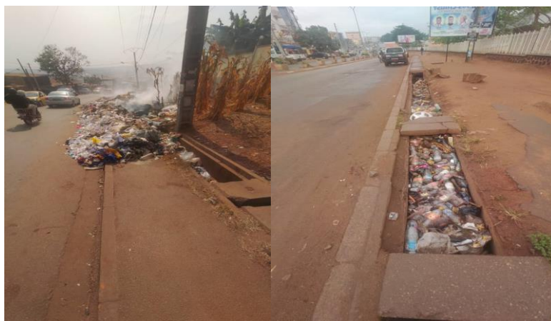
Photo N° 3 : Déchets obstruant les rigoles
