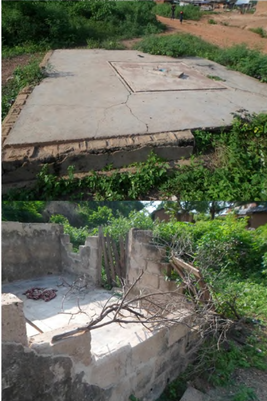
Hydraulique villageois non fonctionnel (photo 13 : photographie ADOU Léon)
