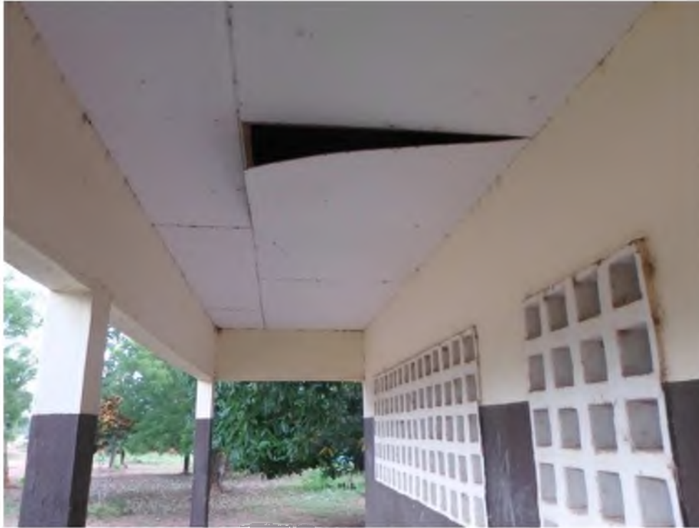
Plaffond dégradé (photo 8 : photographe ADOU Léon)
