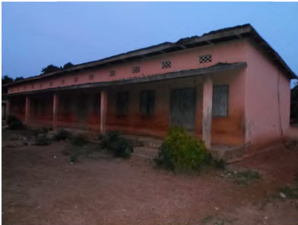
Une école dont la toiture est presque inexistant (photo 11 : photographe ADOU Léon)
