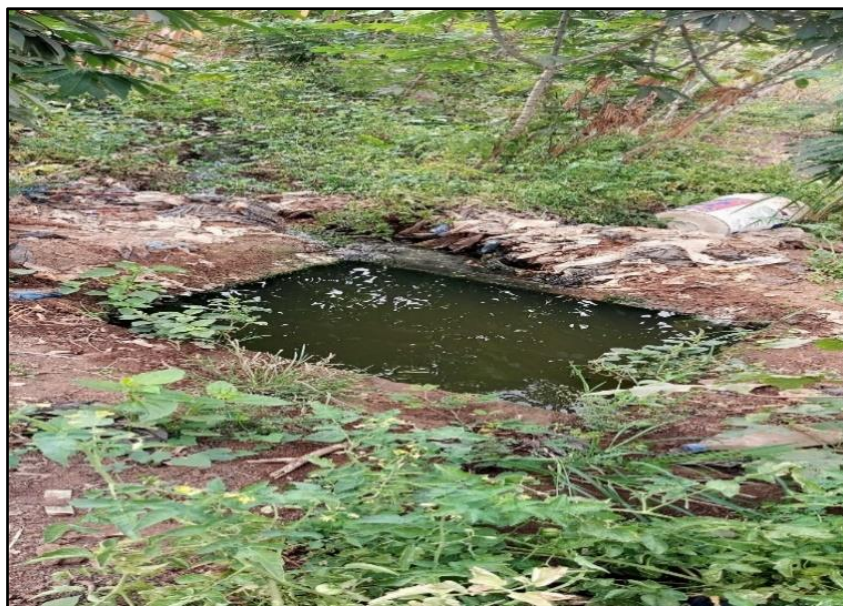
Figure 17 : Regard 2 (P2) du réseau d'assainissement de l'EPHR
