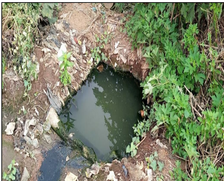
Figure 16 : Regard 1 (P1) du réseau d'assainissement de l'EPHR
