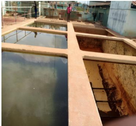
Unité de traitement Classique 1
