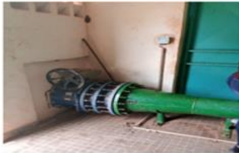
Conduite de sortie de la salle de commande
