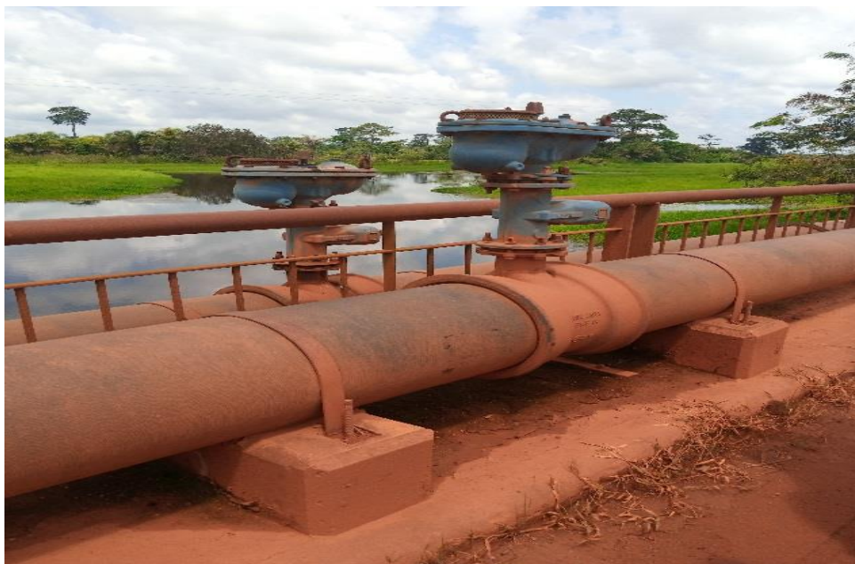
Figure 20 : Conduites d'adduction d'eau brute
