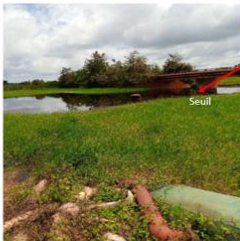
Pompage sur la rivière Lobo
