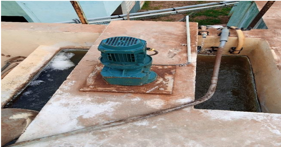
Figure 25 : Injection du chlore et du sulfate d'alumine dans la vasque d'arrivée d'eau brute
