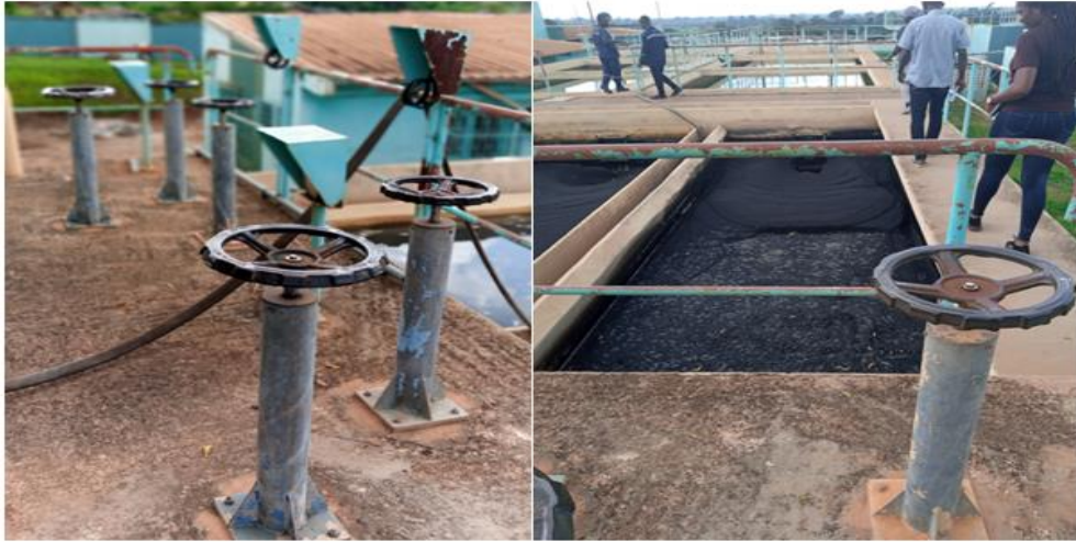
Figure 42 : Vannes pneumatiques hors service
