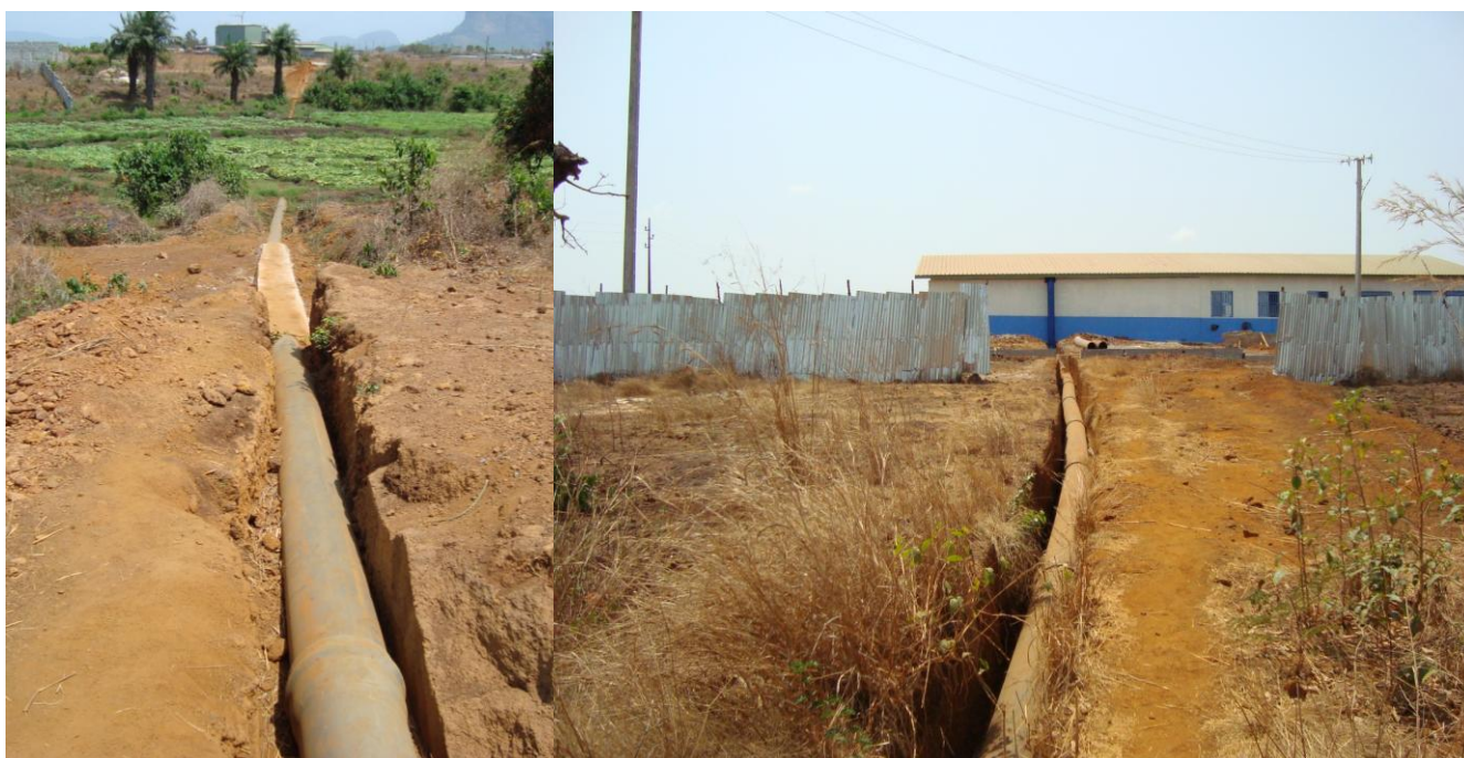
Photo d'une conduite PVC diam 315 PN16 pour le projet de refoulement d'eau potable à Conakry (2010)
