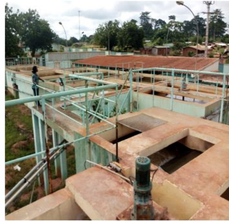
Unité de traitement Classique 2
