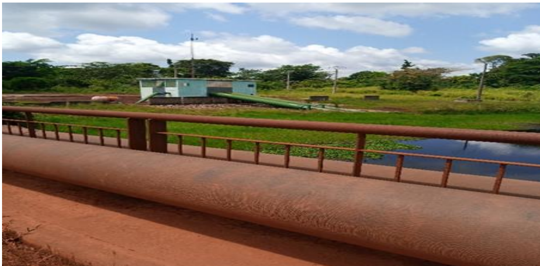
Figure 17 : Station de pompage du système d'AEP de la commune de Daloa
