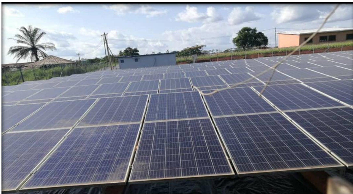
Photo 8 : Champ solaire fonctionnel
