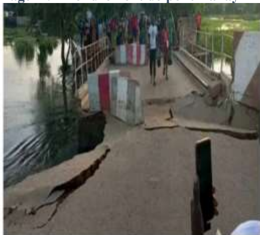
Image 1: Effondrement de pont Danay
