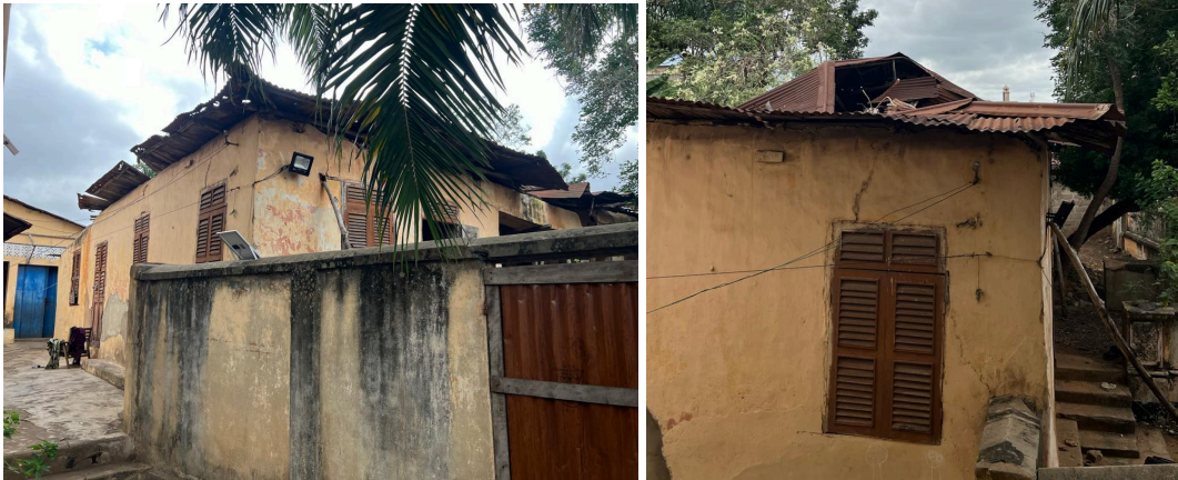
Figure 21 : Photo du premier bâtiment de la Maison Patterson en dégradation
