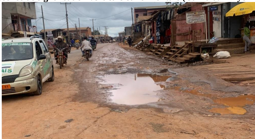
Photo 7: nid de poule sur la voie de circulation au quartier Mvog Beti
