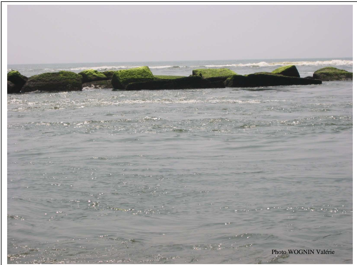
Photo 3 : Epi de protection contre l'érosion isolé par la mer à Grand –Lahou (4 janvier 2003)
