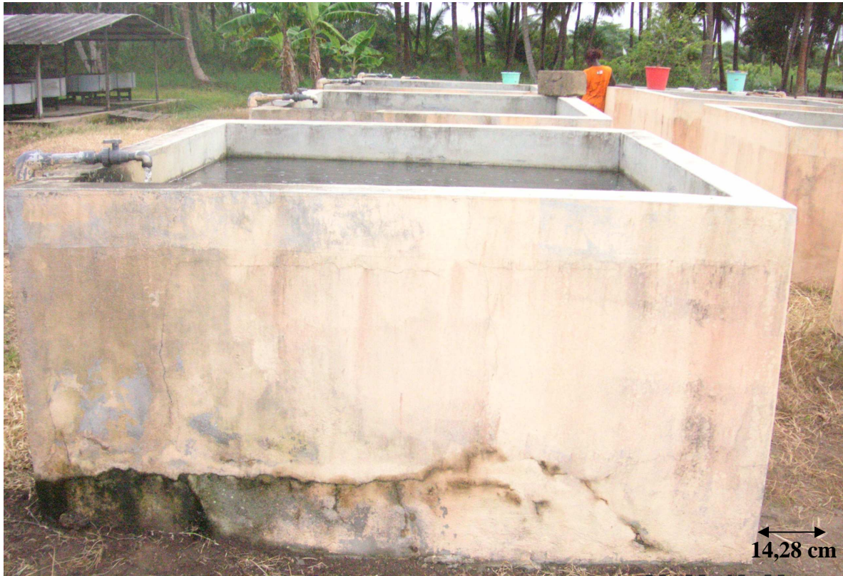
Photographie 4 : Bacs en béton à la Station d'Aquaculture Expérimentale de Layo
