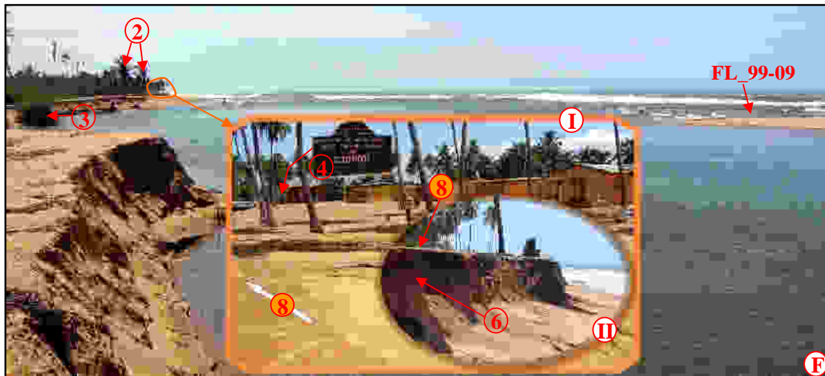
Photo 18.- Photographies montrant l'état de la côte aval avec la reprise de l'élongation de la flèche sableuse
