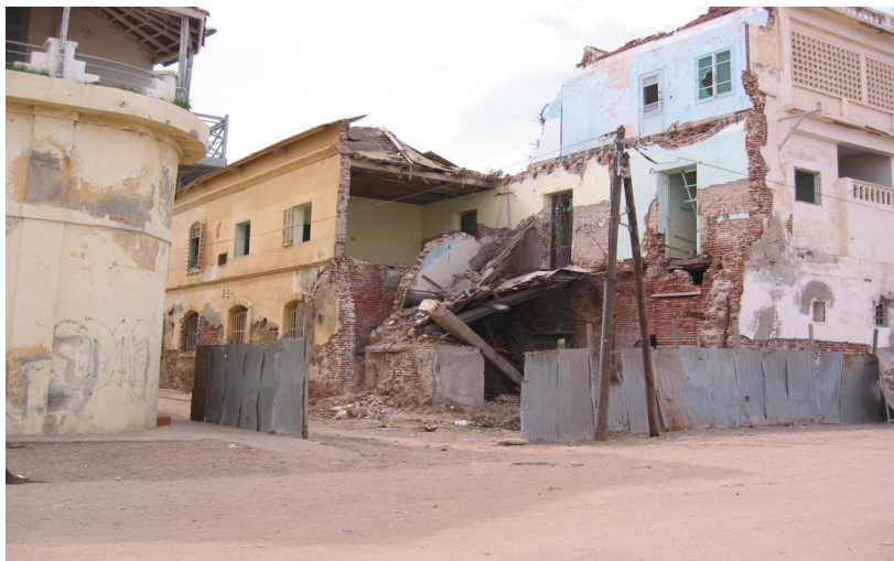
Effondrement d'un bâtiment sur le quai Henri Jay suite à la construction d'un étage supplémentaire
