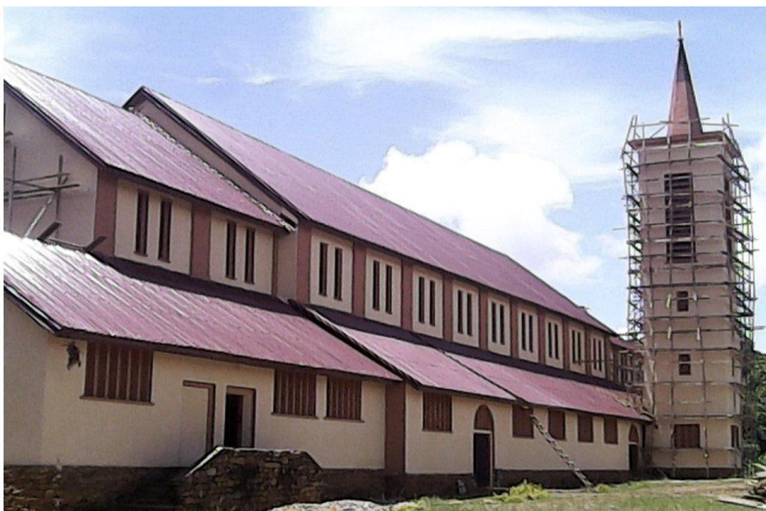
Photo 5 : La paroisse catholique de NKOLMEBANGA, au collège Bullier, en cour de rénovation.
