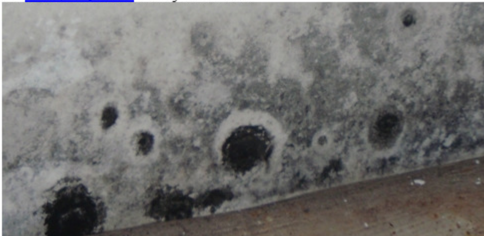
Photo 1 : Développement de la moisissure sur un mur
