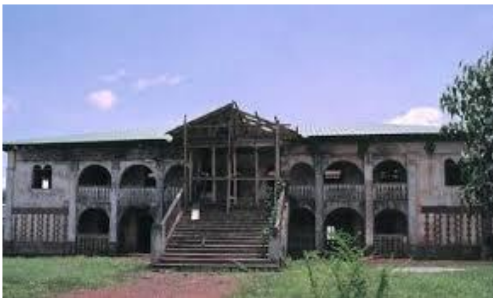
Voire Photo N°10 : Palais Charles Atangana en état de délabrement
